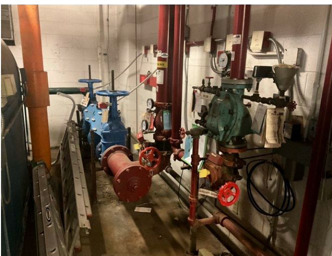
23 - FIRE SPRINKLER RISERS
